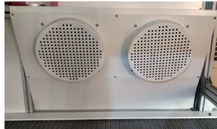
Sistema de exaustão
